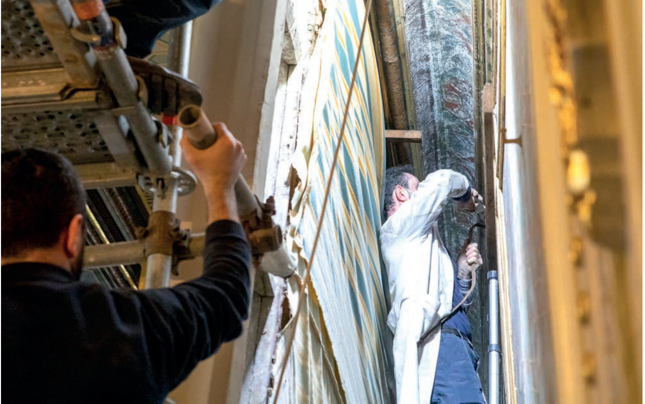
22 Eserin duvarla bağlantısının kesilmesi
